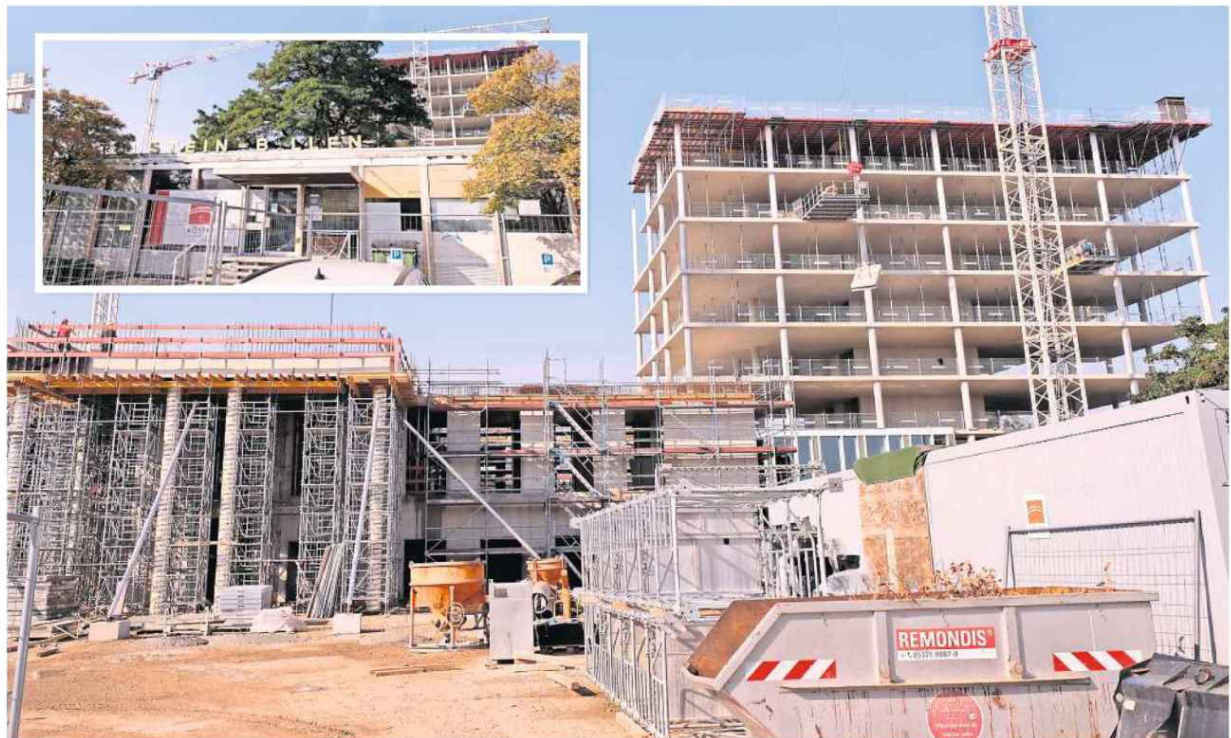
Riesenbaustelle neben der Berliner Brücke: Das Berliner Haus liegt im Zeitplan und soll im März 2022 fertiggestellt werden. Was aus dem Billen-Pavillon wird, ist noch offen.
