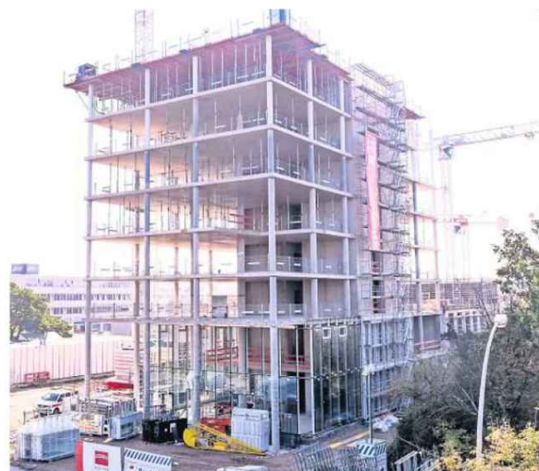
Baustelle für das Berliner Haus: Neben einem Hotel mit 260 Betten entsteht dort ein Büroturm mit 6700 Quadratmetern Fläche.
