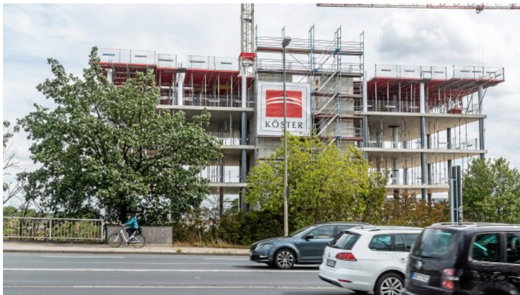
Die Gebäude, die zurzeit gebaut werden, verändern die Stadtsilhouette in der Mitte Wolfsburgs. Foto: Helge Landmann / regios24 / Archiv
